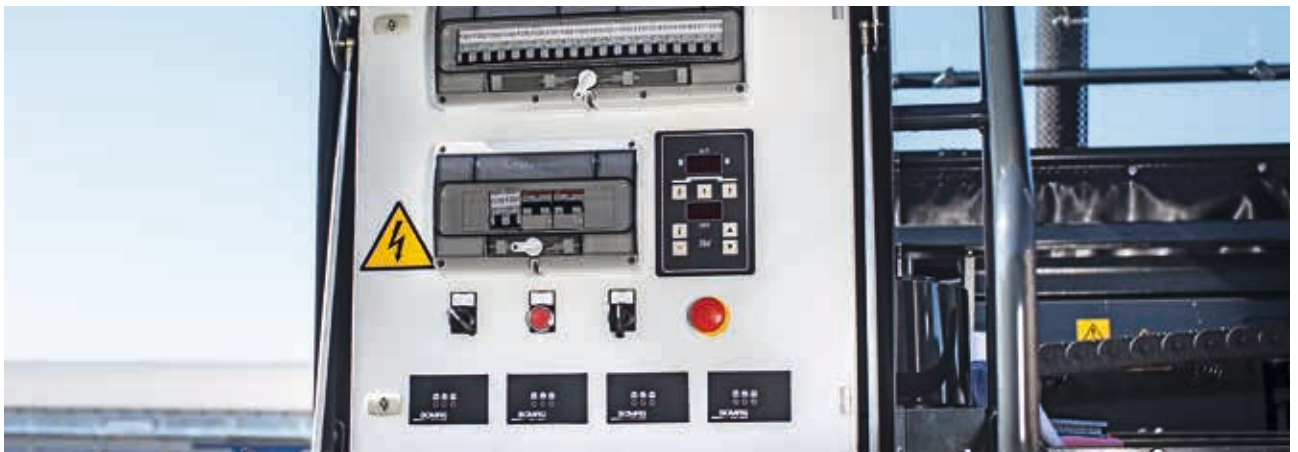
Bedienfeld mit Heizungsüberwachung.
